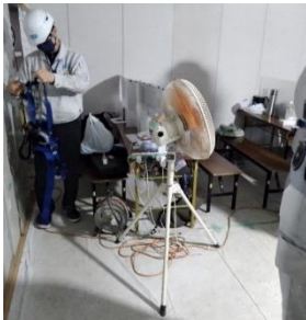
休憩場所に業務用扇風機の設置
