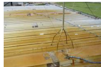
事務所屋上に設置したスプリン クラー
