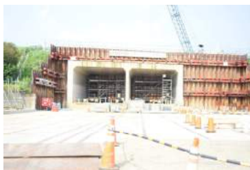
アンダーパスの函体。作業ヤードには板が敷設されている
